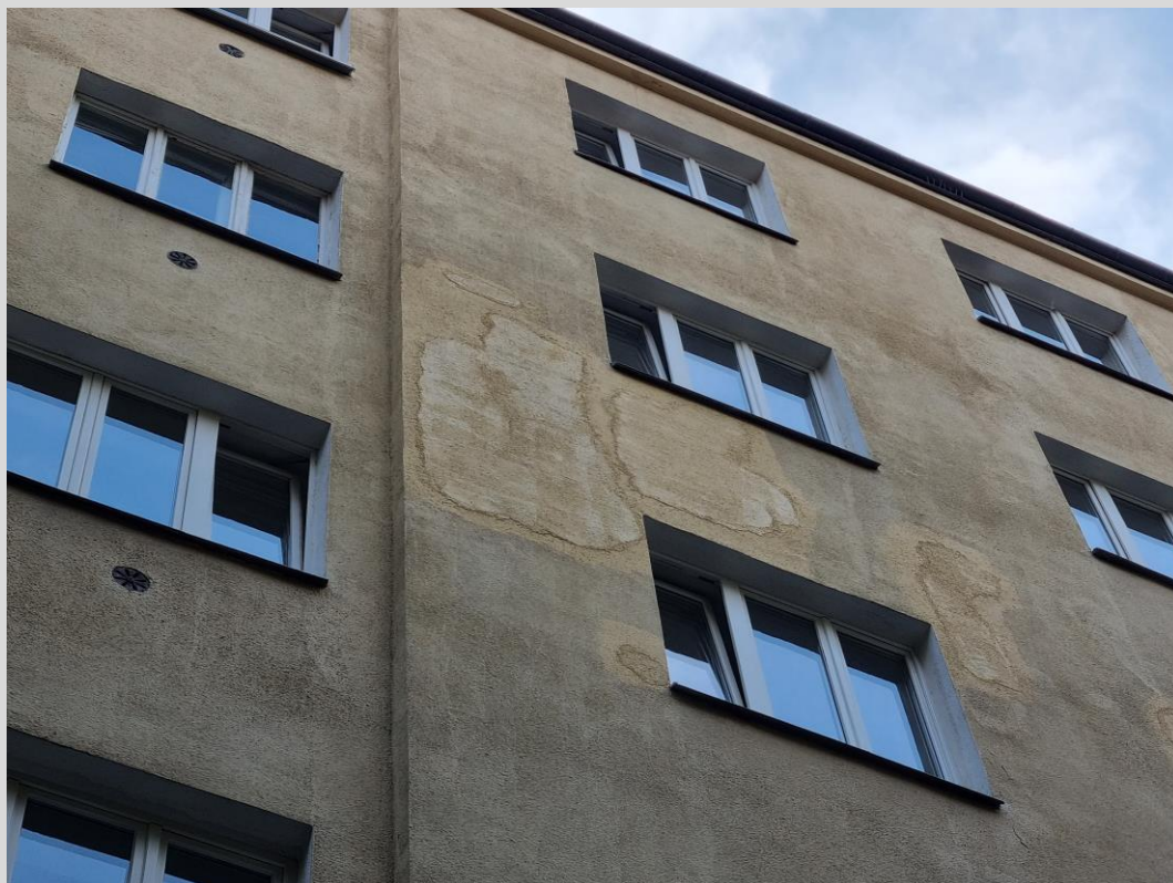
Fotografia 20 Widoczne ubytki tynków oraz ślady po ich naprawach.
