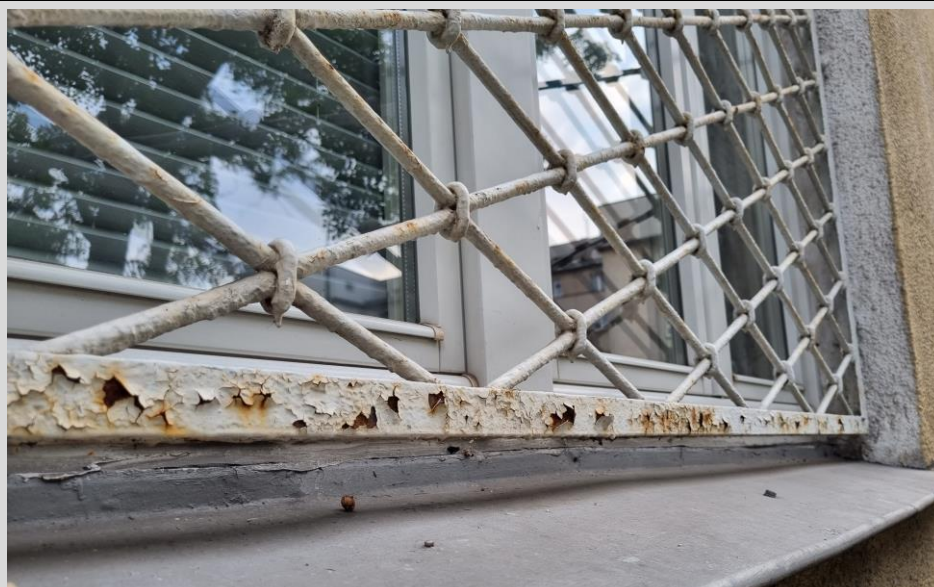
Fotografia 28 Widok powierzchniowej korozji krat okiennych.
