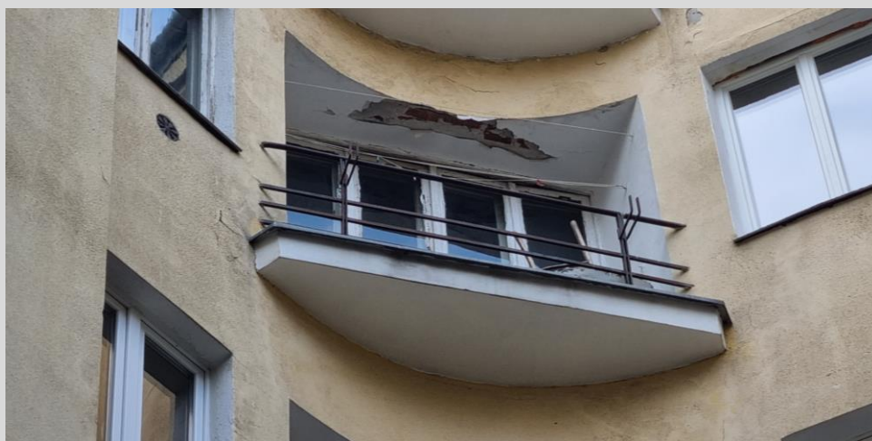
Fotografia 23 Widoczne ubytki warstw tynkarskich na nadprożu drzwiowym balkonu.
