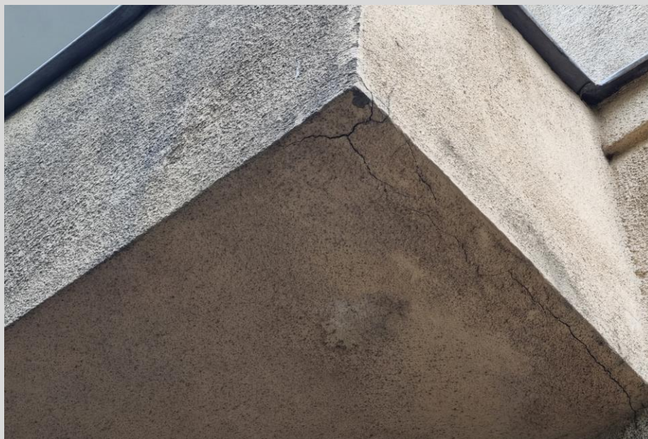
Fotografia 24 Widoczne pęknięcia balustrad pełnych balkonów.
