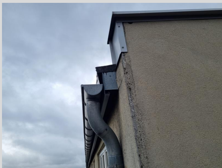
Fotografia 19 Widoczne uszkodzenia narożnika ściany VII-go piętra.
