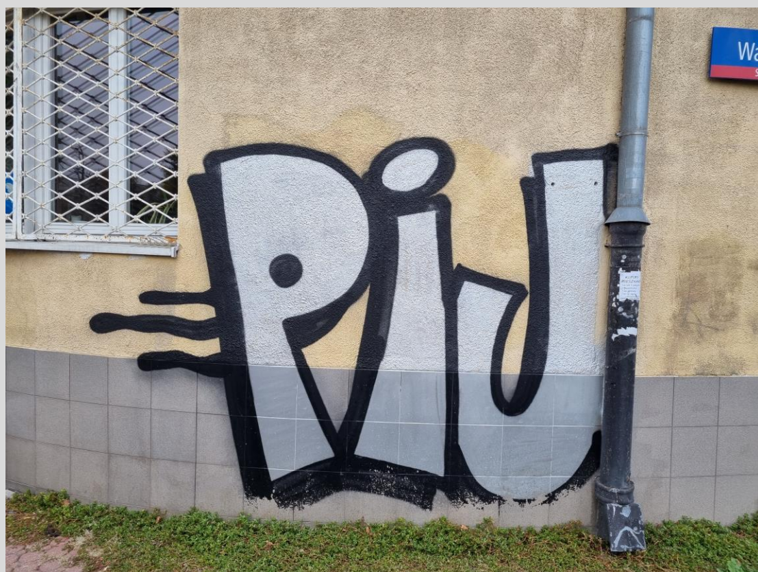
Fotografia 32 Widoczne napisy farbą w spary-u na powierzchni elewacji.
