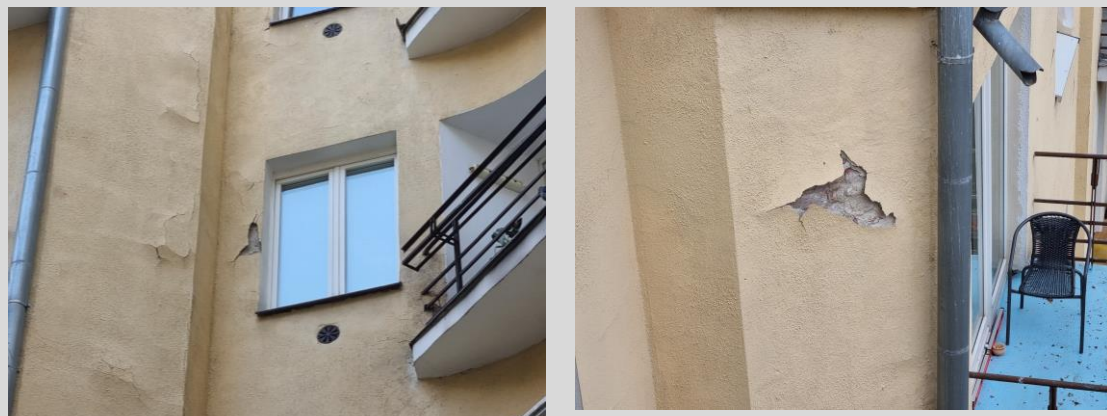
Fotografia 16 i 17 Widoczne odspojenia warstw tynkarskich.
