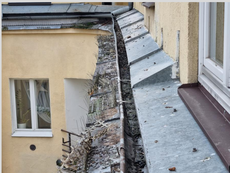
Fotografia 31 Widok skorodowanych obróbek blacharskich oraz niedrożnych rynien w poziomie VI-go piętra.
