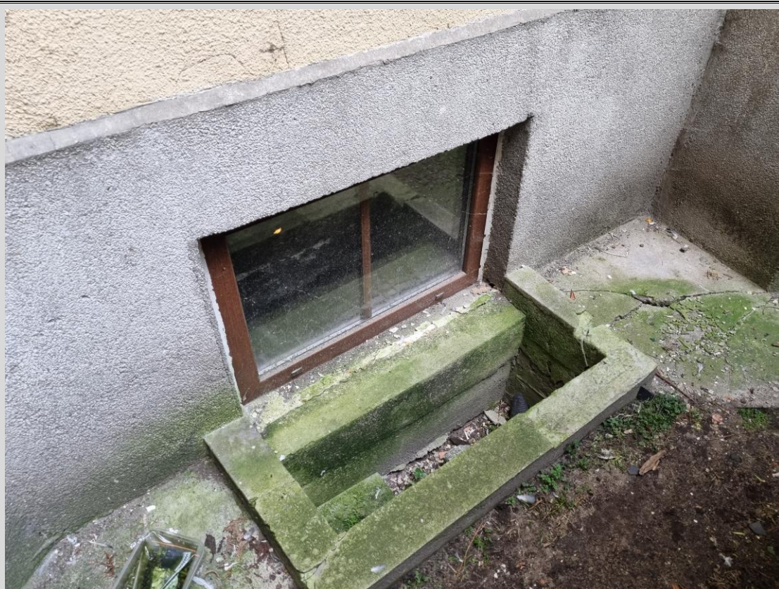
Fotografia 31 Widoczne zagłoniczenia nisz okiennych.
