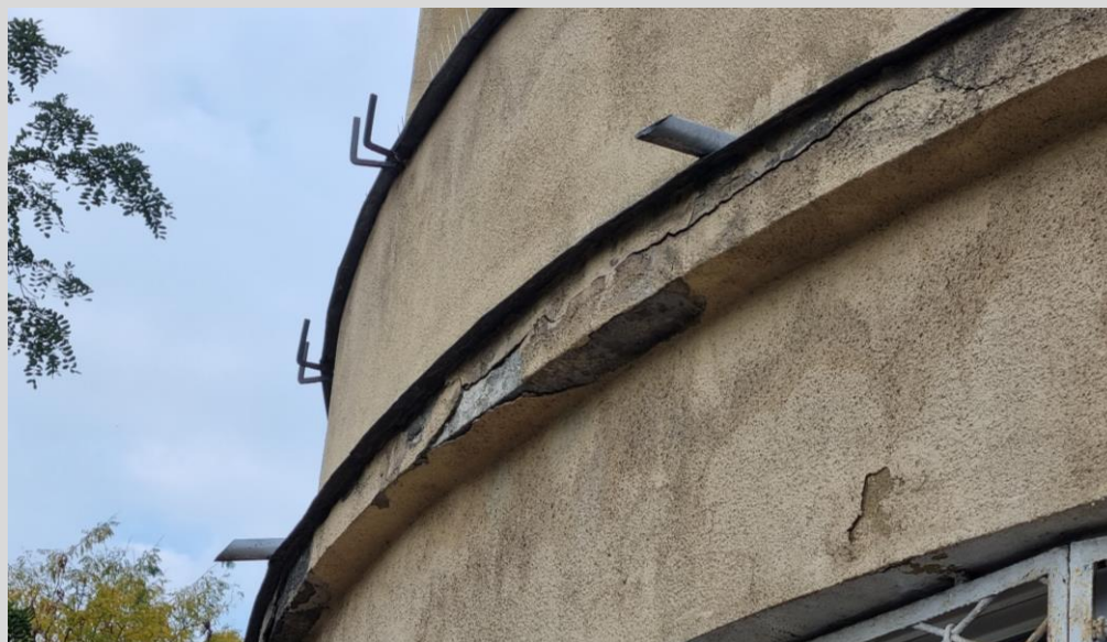
Fotografia 18 Widoczne pęknięcia oraz zalania gzymsu nad parterem-elewacja frontowa.
